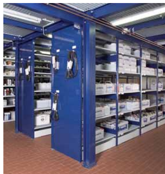
Skladování baterií a jiného rizikového zboží na policích se záchytnými vanami
